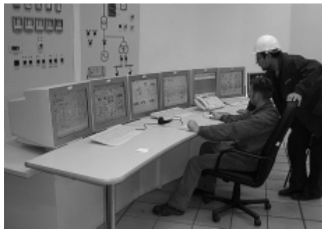
Рис. 1. Щит управления ТП
