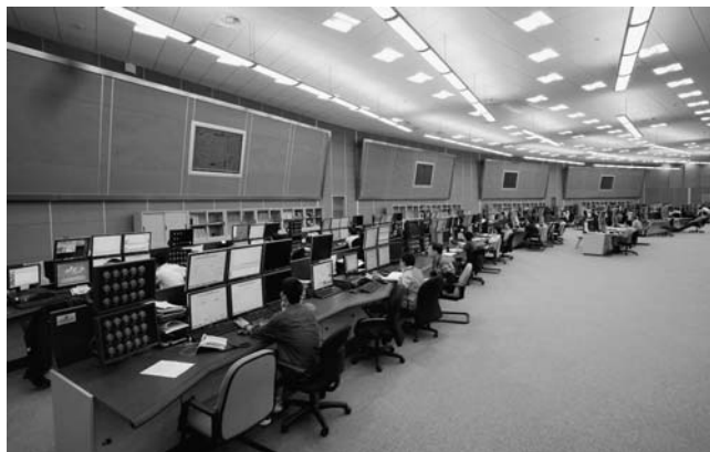
Рис. 3. Единая операторная является центром управления 10 заводами крупнейшего нефтехимического комплекса SECCO (Шанхай)
