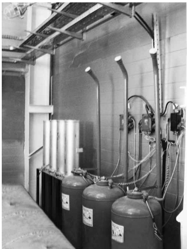
Комбинированная система аэрозольно-порошкового пожаротушения в газоперекачивающей станции №11 п. Богандинский Тюменская обл.
