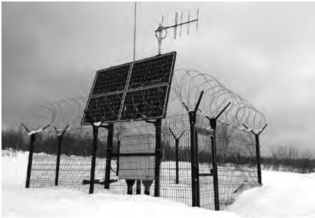
Рис. 6. Контролируемый пункт телемеханики с возобновляемым источником электроэнергии на базе солнечной батареи
