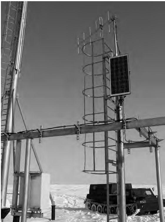
Рис. 2. Контролируемый пункт куста газовых скважин
