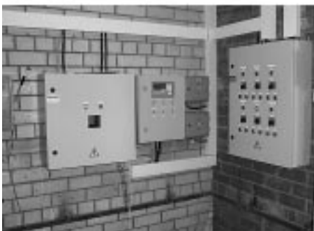
Рис. 4. Шкафы автоматики "Деконт" на теплопунктах г. Королева
