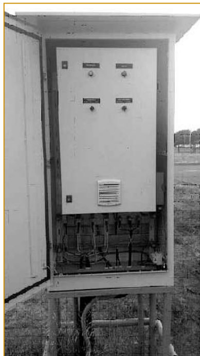
Рис. 2. Реализация уличного шкафа управления
