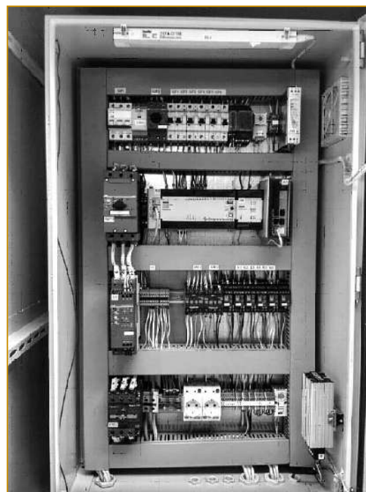
Рис. 3. Эргономика шкафа автоматизации
