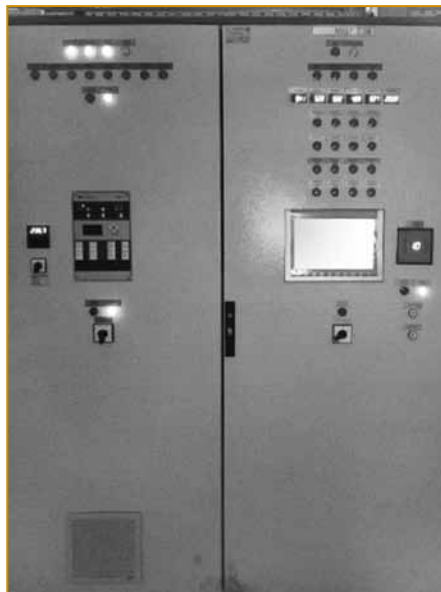
Рис. 2. Новый шкаф автоматики МЩУ-39
