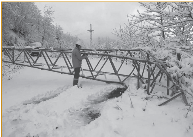
Рис. 2. Упавшая под тяжестью льда опора вследствие ледяной бури в гористом районе Турции
