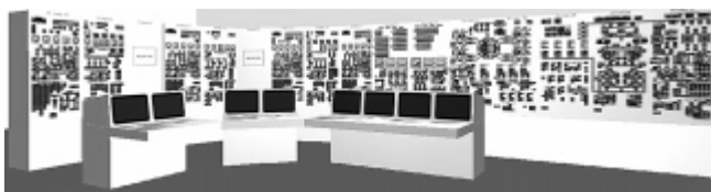
Рис. 3. Общий вид комплекса технических средств ОДУ
