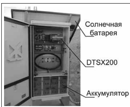
Рис. 10. Пример установки DTSX200 в месте разработки ресурса
