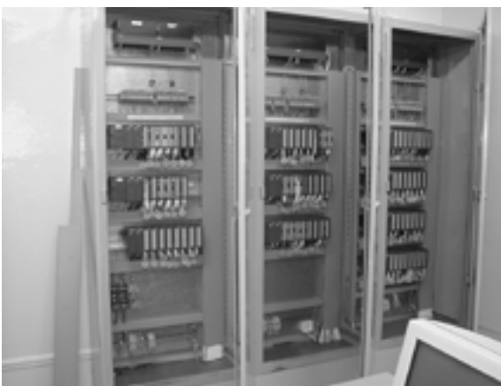
Шкафы управления системой PCS7
