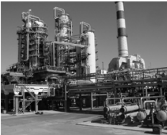
Установка АВТ-5 под управлением системы PCS7
