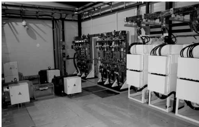
Рис. 1. Общий вид электромашинного помещения
