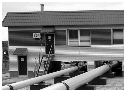
Рис. 5. Некорректное расположение сплит-системы
