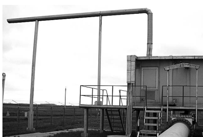
Рис. 2. Некорректная конструкция воздухозабора
