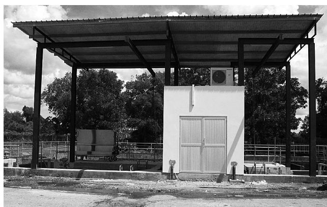
Рис. 5. Блок-модуль шкафов управления в Гадонг
