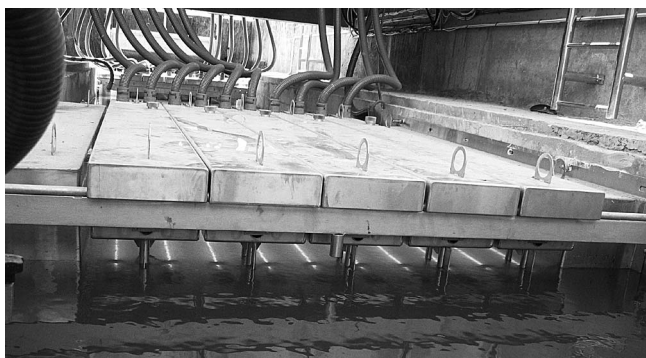
Рис. 4. Камера обеззараживания в виде открытого бассейна на станции очистки сточных вод в Гадонг (Бруней)
