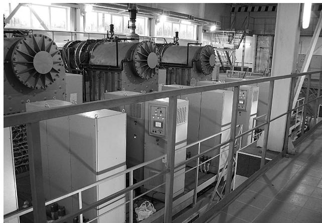
Рис. 3. Цех обеззараживания питьевой воды на Слудинской станции водоподготовки в г. Н.Новгороде
