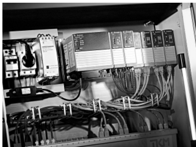
Рис. 2. Промышленный модульный коммутатор Hirschmann PowerMice, установленный в производственном цеху
