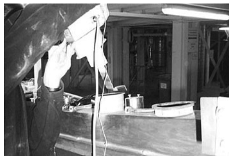
Рис. 3. Монтаж прибора SlideControl
