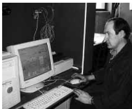
Рис. 4. АРМ оператора на котельной ОАО "ЗЭиМ"
