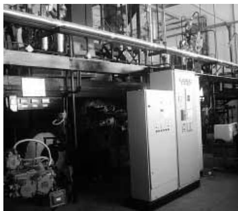
Рис. 1. Шкаф управления в АСУТП парового котла, НГДУ "Краснохолмскнефть"
