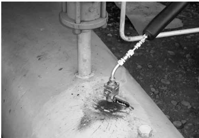
Рис. 4. Некачественный монтаж пробоотбора
