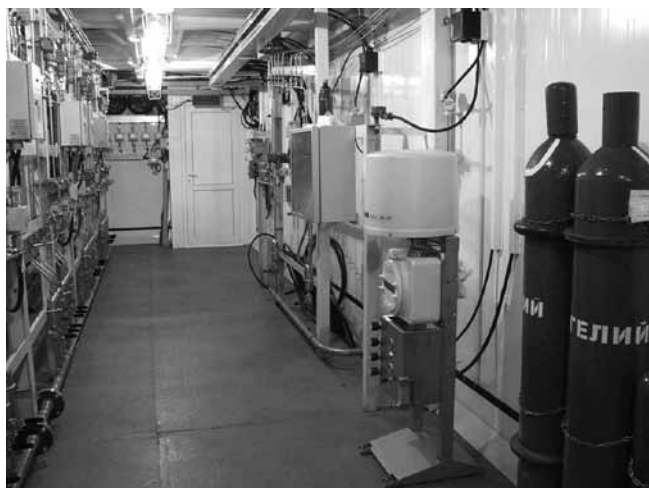
Рис. 2. Размещение модуля системы измерения ФХП газа в блок-боксе
