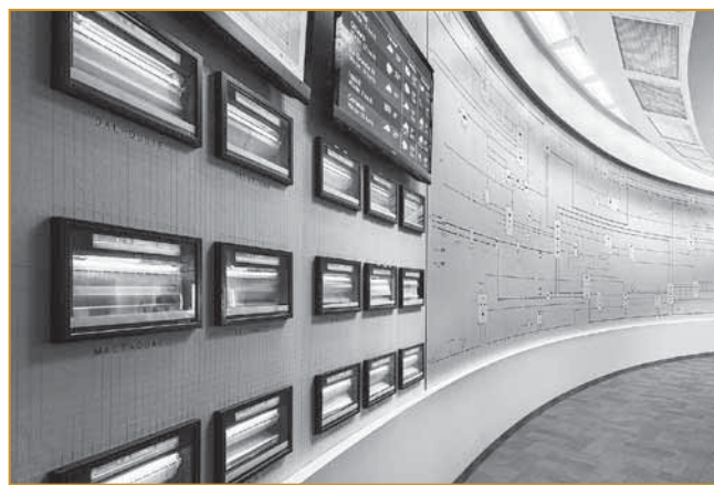
Рис. 3. Центр управления сети NB Power (Фредериктон, Канада)
