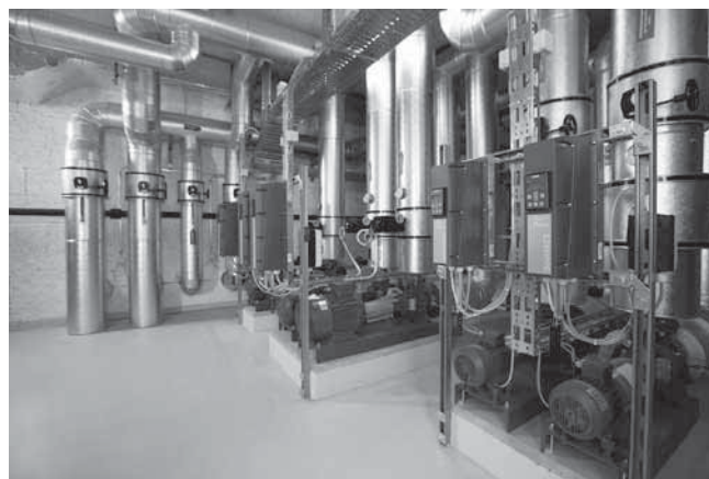
Рис. 4. Внутри насосной станции Бюргеншток
