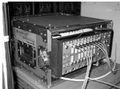
Рис. 3. Измерительная станция в ВВК электровоза
