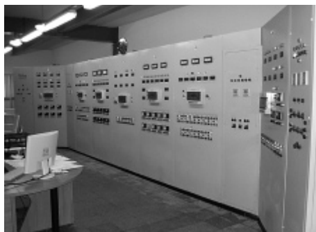
Рис. 1. Главный щит управления (ГЩУ) ТЭЦ
