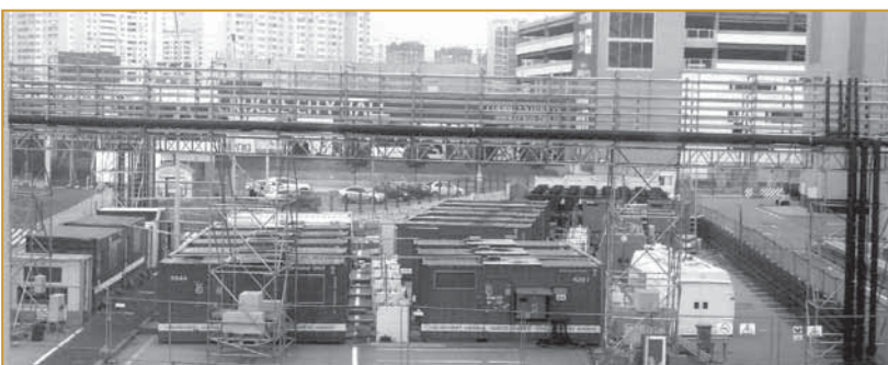
Рис. 2. Блок дизель-генераторных установок (ДГУ) МВЦ ЧМ 2108
