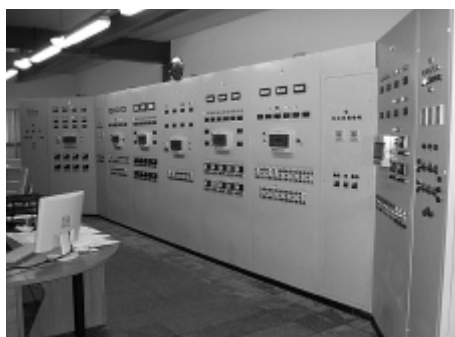
Рис. 1. Главный щит управления (ГЩУ) ТЭЦ
