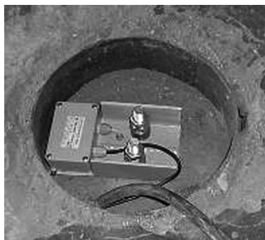
Рис. 2. Фотография головки термоподвески, установленной в силосе элеватора
