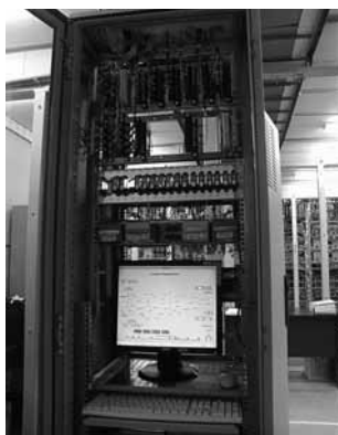
Рис. 5. Концентратор IPC610 в шкафу ЛПД. Пост электрической централизации ст. Гатчина
