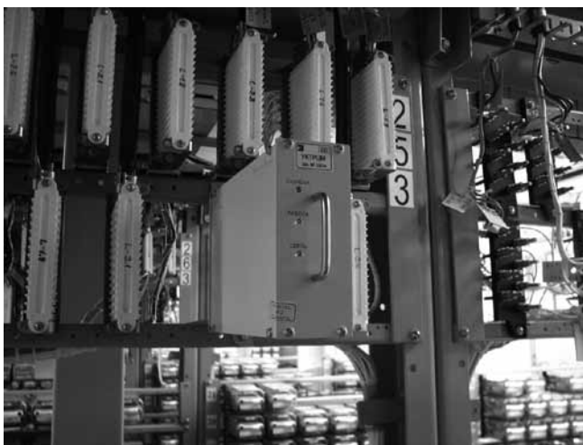
Рис. 3. Измерительный контроллер УКРЦМ на станине поста электрической централизации
