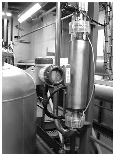
Рис. 5. Типичная установка на химическом заводе
