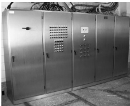
Рис. 2 Шкафы управления отделения централизованной мойки
