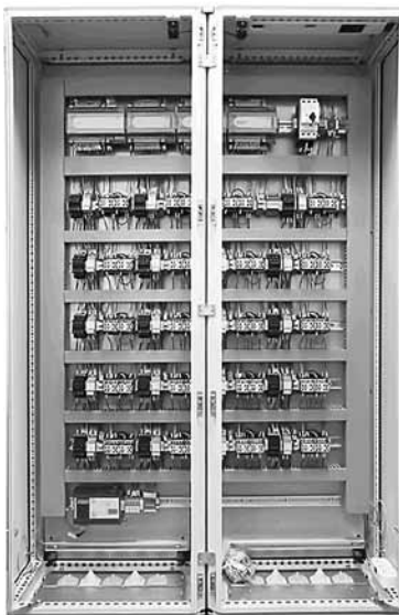
Рис. 1. Шкаф управления обессоливающими цепочками
