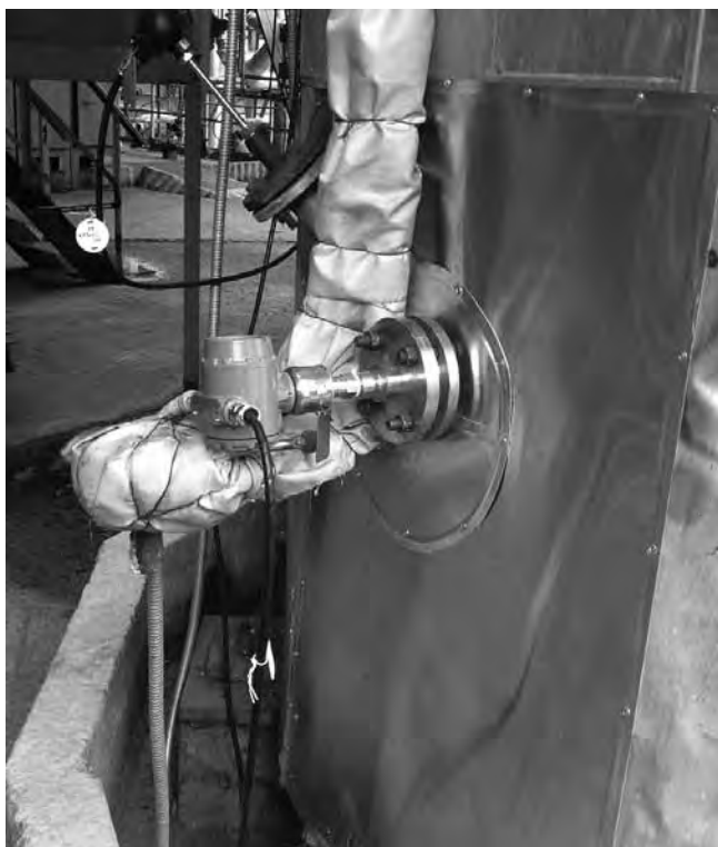
Рис. 5. Место установки системы ERS
