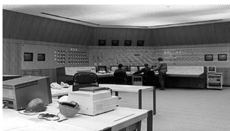
Рис. 1. Вид блочного щита ОАО "Пермская ГРЭС"
