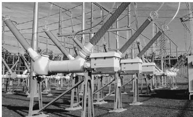
Рис. 5. Одна из подстанций компании Powerlink, где применяются НИТ
