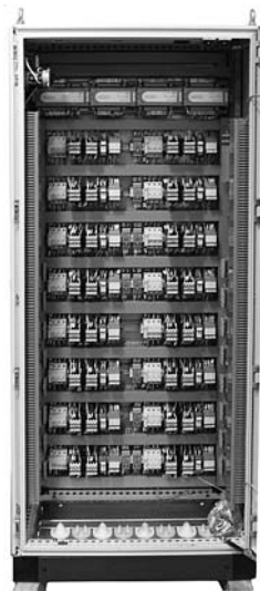
Рис. 7. Пример реализации интеллектуальной сборки РТЗО для 16-ти реверсивных задвижек на базе интеллектуального модуля М932С контроллера TREI-5B-05
