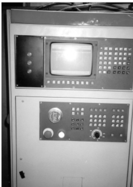
Рис. 1. Станок 04 ИВ200-02 после установки системы ЧПУ NCT 2000 с монохромным монитором
