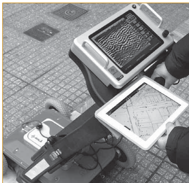
Рис. 2. Сотрудник EYATh использует связь в виде мобильной ГИС и специального радарного устройства, позволяющего точно определить местоположение подземных коммуникаций
