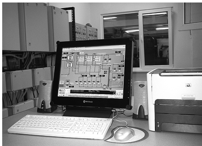
Рис. 5. Центральный пункт управления
