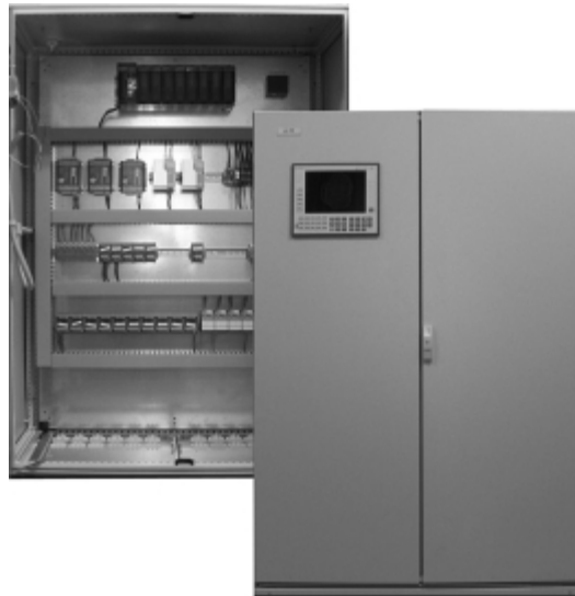
Рис. 3. Шкаф САУ ГРС настенного исполнения: САУ выполнена на базе ControlWave; для локального отображения и управления используется плоская панель оператора (на левой двери)
