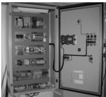
Рис. 1. Шкаф распределения электроэнергии и управления K1V1
