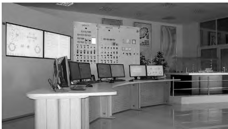
Рис. 4. Диспетчерский пункт управления энергоблоком №1 Красноярской ТЭЦ3
