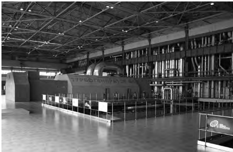
Рис. 3. Энергоблок №1 Красноярской ТЭЦ-3
