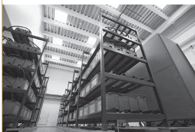
Рабочие помещения ЦОД «ТрастИнфо»
