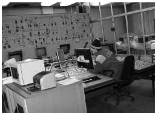
Отладка ПТК на промышленном объекте
