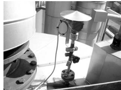
Рис. 3. Сенсор ERS низкого давления, установленный наверху резервуара
